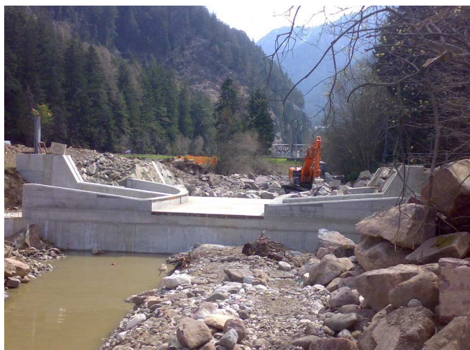
Figure 1/2. Stazione idrometrica rio Gardena a Pontives, riferimento per il monitoraggio idrometrico di tale corso d'acqua.
