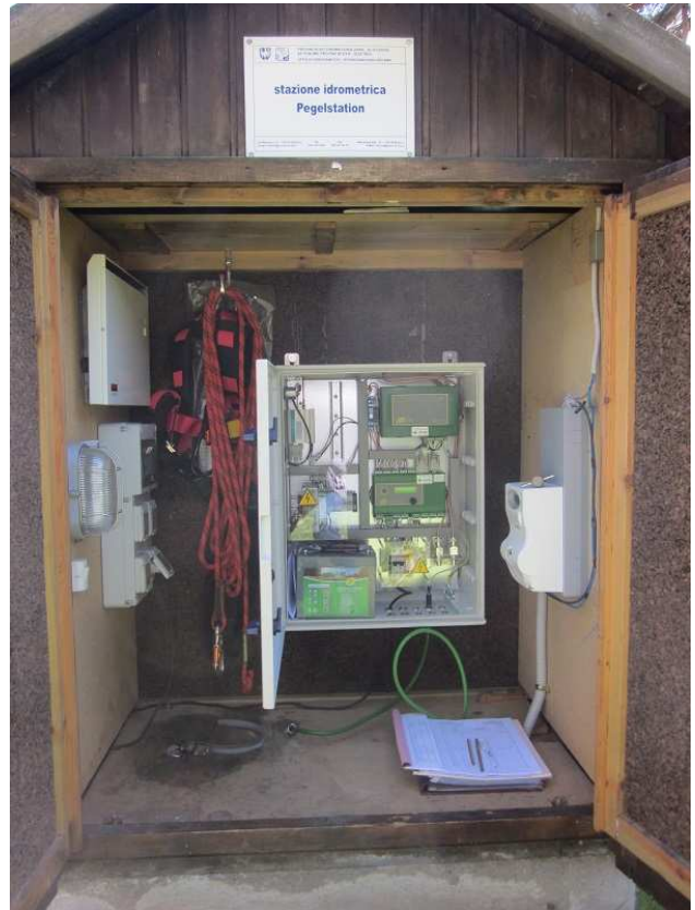
Abb.2 Pegel Einperlsystem - Bauweise ab 2007
