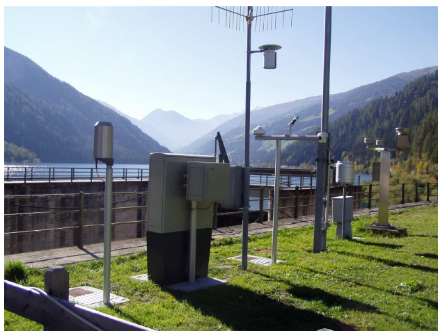
Fig. 1/2 Stazione meteorologica e vista panoramica del serbatoio di Zoccolo.
